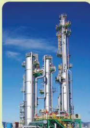
分離・回収設備
